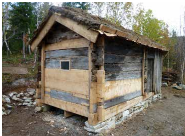
Ol'Andersen buret i Hemnes. Det ble gitt dispensasjon til å flytte buret til et mer sentralt område før istandsetting. Det ble stilt krav om at buret måtte dokumenteres og istandsettes etter antikvariske prinsipper.
